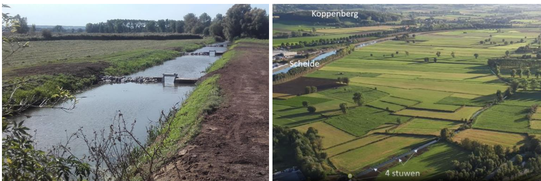
Aanleg van visdoorlatende stuwen in de Langemeersen, Oudenaarde (Bron: Van Braeckel – INBO & Malfroid – Provincie Oost-Vlaanderen, 2021).
